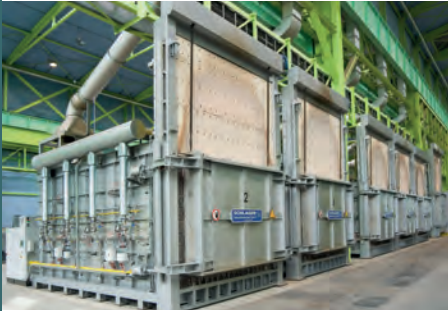
Beispiel einer Installation der Schlager Industrieofenbau beim Kunden
