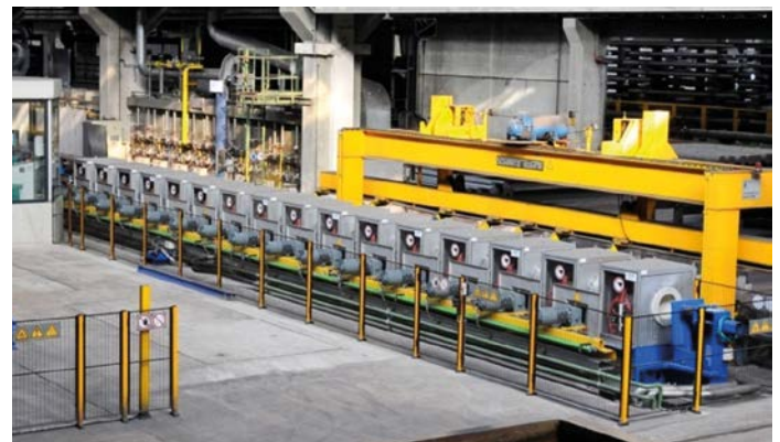
Bild 2: Blick auf die Induktionsanlage im Edelstahlwerk
