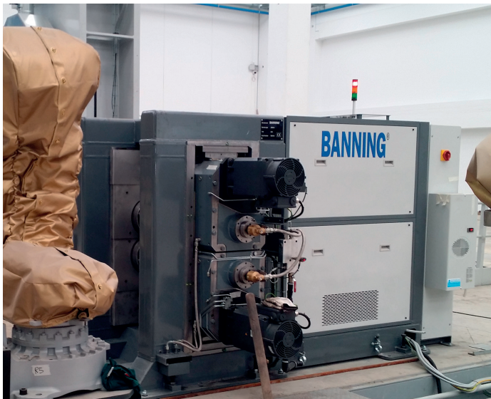
Reckwalze Typ AFR nach Installation beim Kunden
