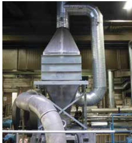
Bild 7: Wärmetauscher über der Isothermkammer mit Umgehungsleitung.
